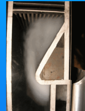
Ausgangszustand ohne Leitblech
